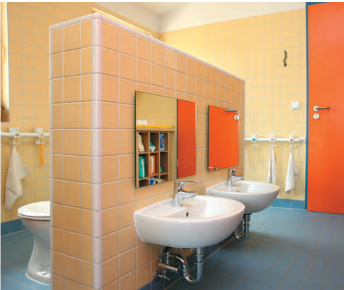
Kneipp-Kindergarten „Max und Moritz“ in Seelow (Brandenburg) Die freistehende Installationswand ermöglicht eine funktionale Anordnung der Sanitärobjekte im Raum.
